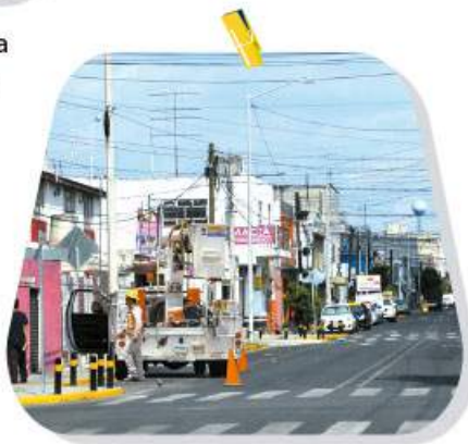
› Alumbrado público en la junta auxiliar de San Baltazar Campeche
