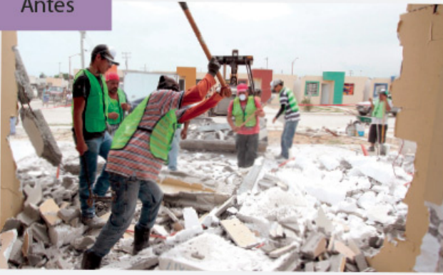
› Casas dañadas por un tornado
